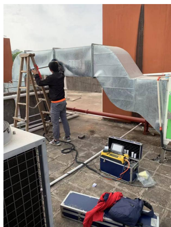
油烟废气处理前检测口
